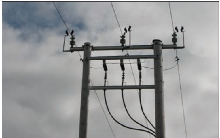
Figur 6. Farlig stolpekonstruksjon på Solværøyene i Lurøy, hvor det ble funnet en død hubro drept av elektrosjokk sommeren 2008. Fra linene går det ned isolerte liner til transformator på bakken.
