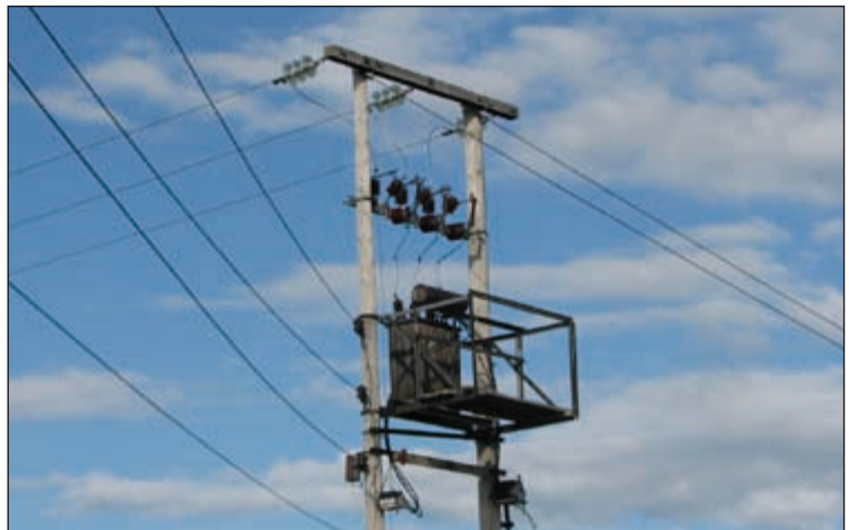
Figur 7. Farlig stolpemontert transformator med kort avstand mellom strømførende liner og mellom jorda deler og strømførende liner, gjør det nødvendig med ekstraordinære isolasjonstiltak. Foto © Jan Ove Gjershaug
