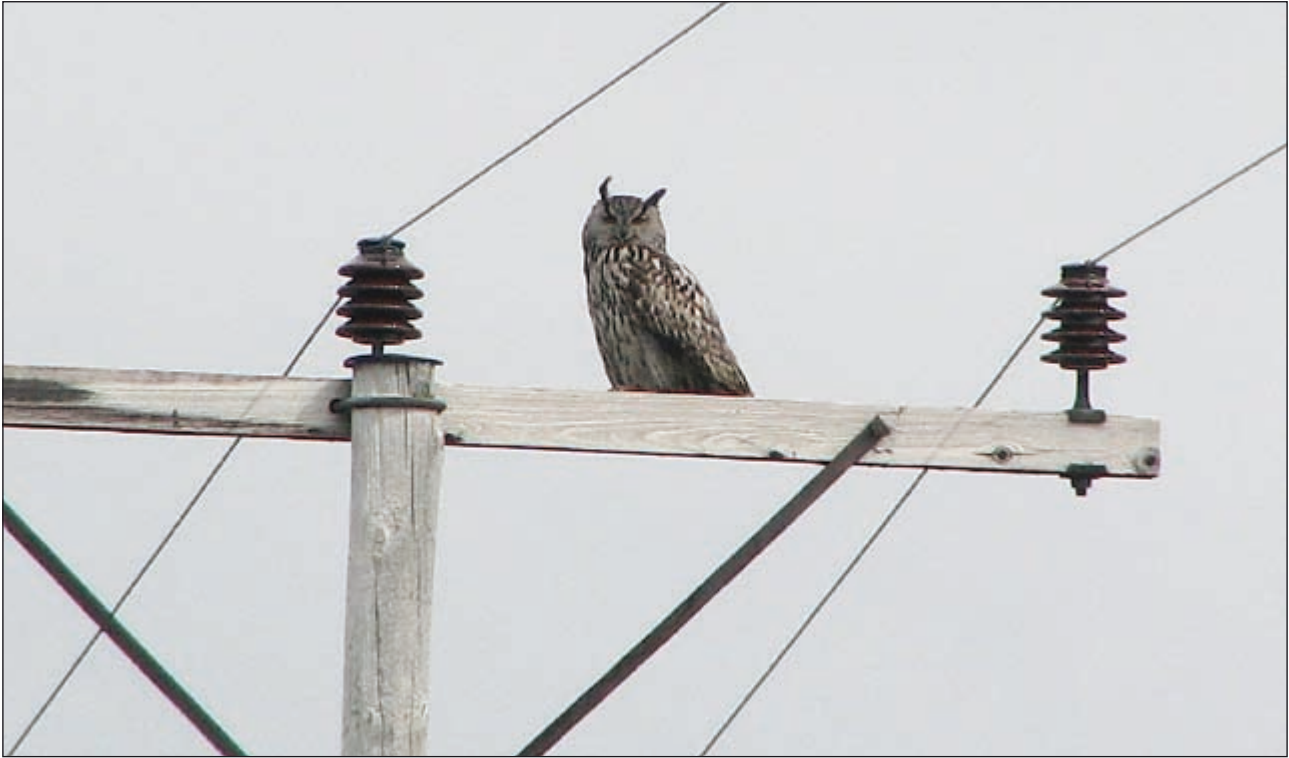
Figur 5. Hubro som sitter på farlig stolpekonstruksjon med toppisolatorer og kort avstand mellom faselederne på Sleneset i Lurøy juli 2008. Dette er en meget vanlig konstruksjon her i landet. Foto © Jan Ove Gjershaug
