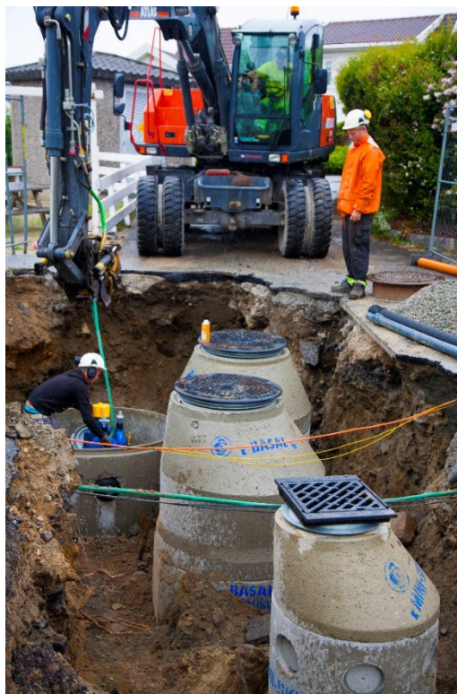
Bilde 18: Utbygging av vatn og avløpsnett i Viste hageby (Foto: Ove Sveinung Tennfjord /Randaberg kommune)
