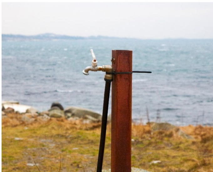
Bilde 19: Vasskran (Foto: Ove Sveinung Tennfjord/Randaberg kommune)
