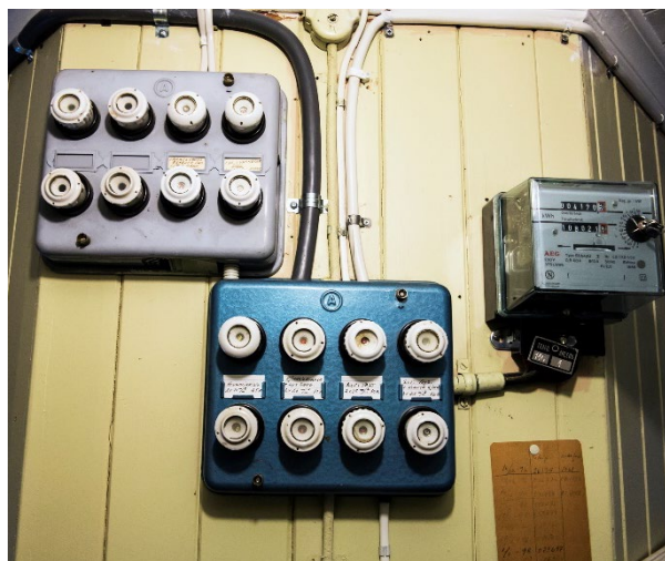
Bilde 24: Gammelt sikringssskap (Foto: Ove Sveinung Tennfjord/Randaberg kommune)
