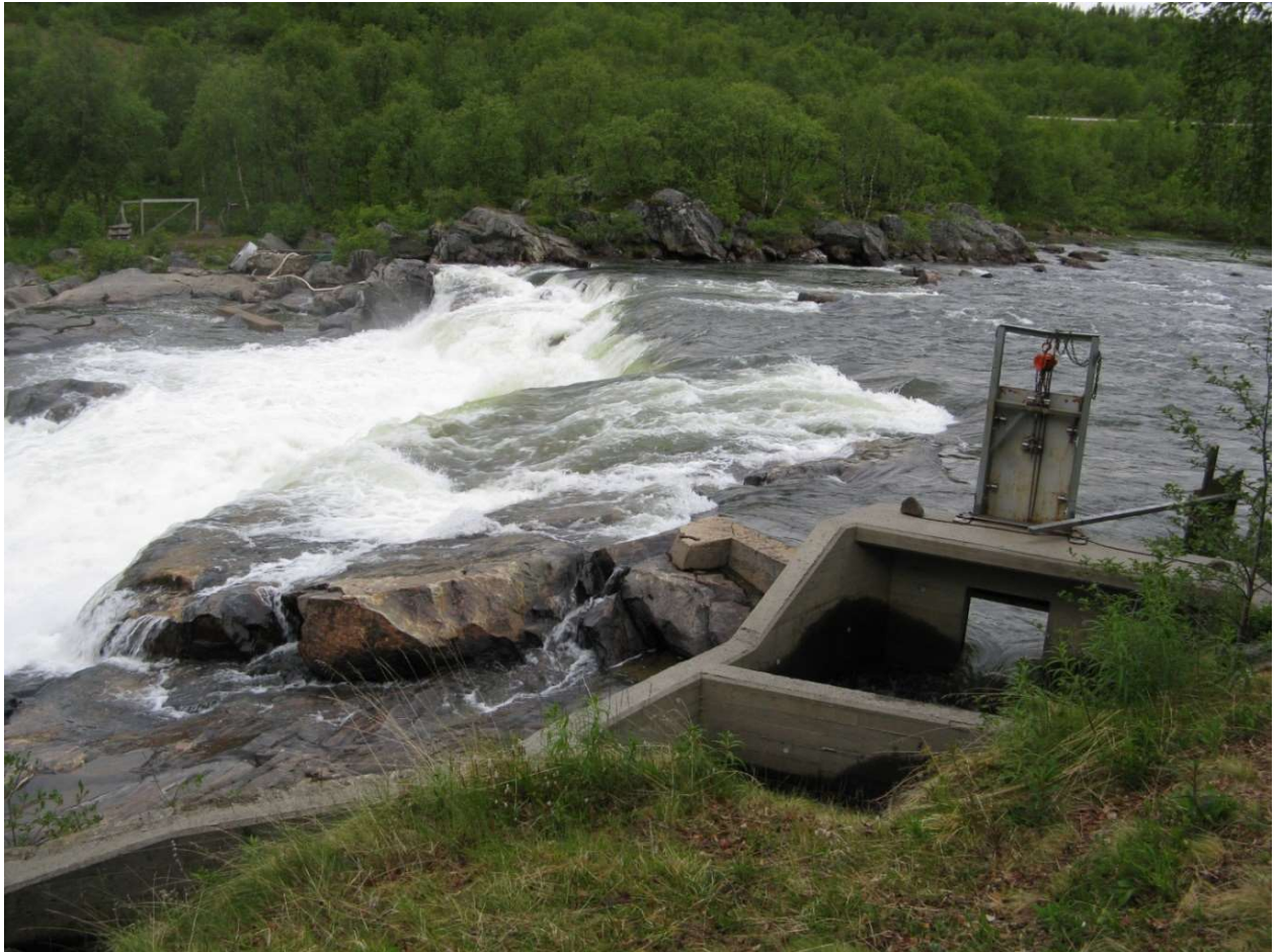
Valokuva 25. Vuoden 2000 syksyllä saatiin kalaportaiden ylimmät kaksi askelmaa valmiiksi ja samalla ulosmenoaukkoon asennettiin kalaportaiden vesimäärää säätelevä mekaaninen luukku. Valokuva Eero Niemelä.
