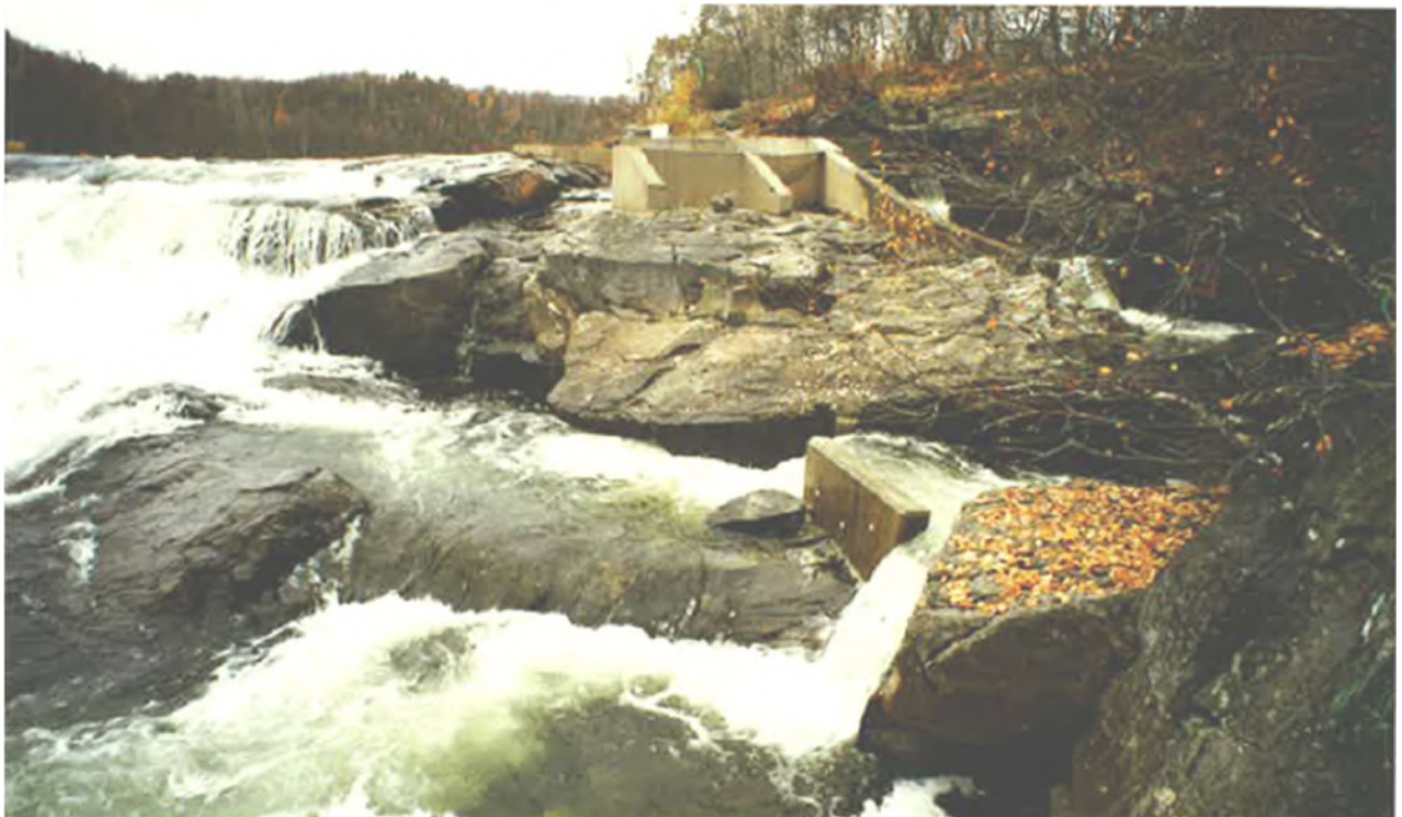
Valokuva 19. Kalaportaan alimman altaan sisääntuloaukko 4.10.1997 korjauksen jälkeen. Syksyllä vuonna 1997 portaiden kuuteen alimpaan askelmaan tehtiin uudet betoniseinät. Joen virtaama 4.lokakuuta oli selvästi suurempi kuin ylemmässä 24. syyskuuta otetussa kuvassa, mistä johtuen alimman portaan ylivirtausaukosta tulee runsaasti vettä. Lohet menevät alimpaan portaaseen pääasiassa varsinaisesta sisääntuloaukosta. Virtaaman ollessa joinakin vuosina heinä-elokuussa normaalia pienempi lohien on vaikea hakeutua sisääntuloaukon kohdalla olevaan joenkohtaan. Valokuva Kjell Moen.
