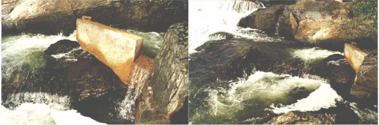
Valokuvat 17 ja 18. Kalaportaan alimman altaan sisääntuloaukko 24.9.1997 ennen korjausta. Valokuvat Kjell Moen.
