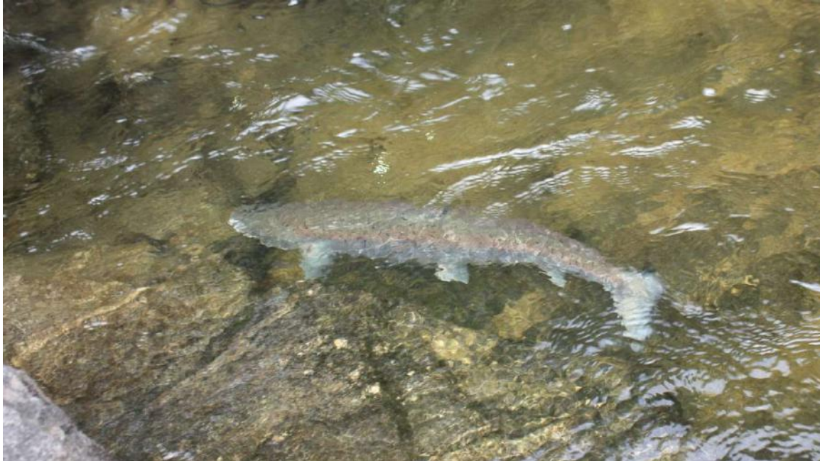
Foto 46. Ved inspeksjon av fisketrappa undersøkes skader i konstruksjonene ved å stenge av vanntilførselen til trappa. På inspeksjonstidspunktet var en 1-sjøvinters laks på under 3 kilo kommet opp i trappa. Foto Ari Kosunen.
