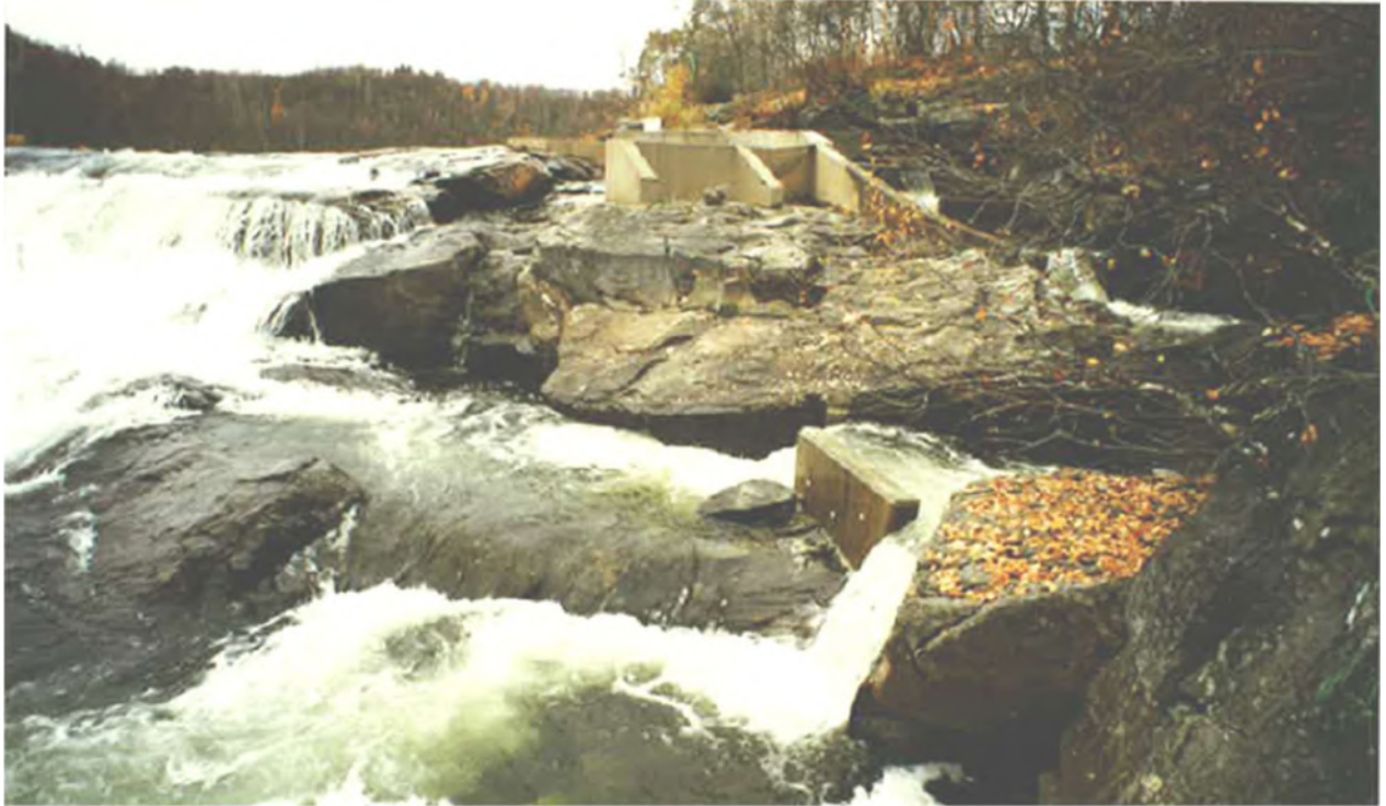
Foto 19. Inngangsåpningen til den nederste kulpen i fisketrappa den 4.10.1997, etter reparasjonen. Høsten 1997 ble det støpt nye betongvegger i de seks nederste kulpene. Vannføringen den 4. oktober er klart større enn på bildet ovenfor, som er tatt den 24. september, og derfor strømmer det mye vann gjennom overstrømmingsåpningen. Laksen går i den nederste kulpen hovedsakelig gjennom den egentlige inngangsåpningen. Når vannføringen i juli-august enkelte år er mindre enn normalt, har laksen vanskelig for å søke seg til det området av elva som er ved inngangsåpningen. Foto Kjell Moen.
