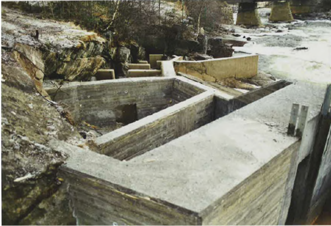
Foto 23. En grundig reparasjon av fisketrappa i Skoltefossen ble fullført i 2000. De to øverse kulpene i trappa ble reparert. Kulpene fikk en større dybde slik at laksen kan hvile i løpet av oppstigningen. Foto Kjell Moen.
